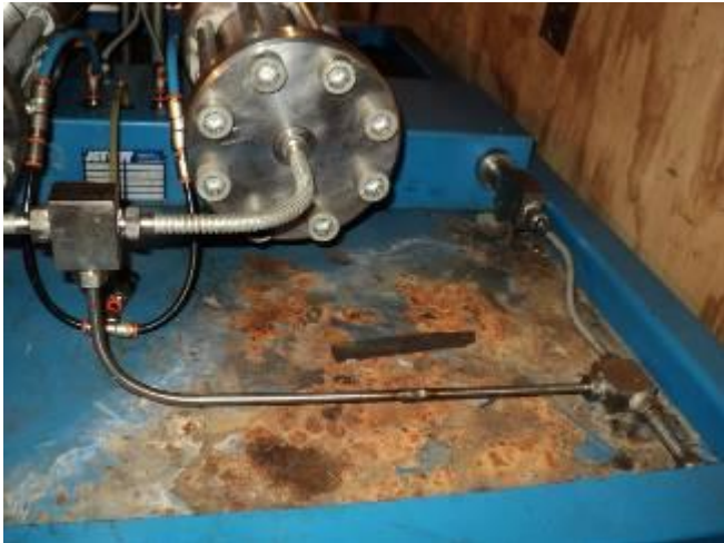
Bild 10: An der Jet Cut Wasserstrahlmaschine ist in den letzten Tagen immer wieder ein Stillstand gemeldet worden. Es kam immer der Alarm Unterdruck und das ist, als wenn zu wenig Wasser oder zu wenig Luft da wäre. Aber das war immer genügend vorhanden. Also werden andere Ursachen gesucht. Eine war, dass bei 2 Relais, die die Kolbe des Zylinder immer hin und her bewegen, die Kontakte abgebrannt sind, weil das tausende mal schalten stark funkt. Wir wechselten die Relais und arbeiteten weiter und beobachten.
