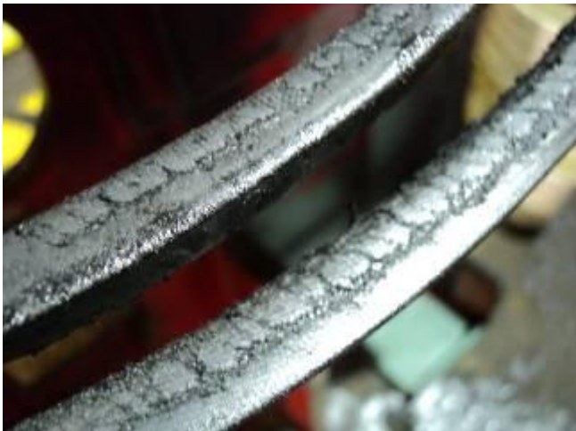
Bild 19: Ja diese Keilriemen müssen auch ersetzt werden, sind aber nicht an Lager.
