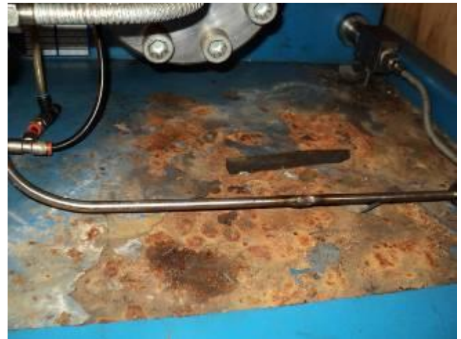
Bild 11: Hier wurde auch ein defektes Rohr geschweißt. Durch diese Rohre geht aber über 3000 bar Druck, also haben wir neue Rohre aus der Schweiz organisiert, damit diese ersetzt werden können. Ist nicht ungefährlich.
