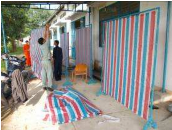
Photo 16: Schutzwände zwischen den Maschinen verhindern dass Späne, Schweisslicht, Schleifstaub den Nachbarn gefährden. Jeder, der an einer Maschine arbeitet, ist jetzt verantwortlich, dass er keine Dritten gefährdet.
