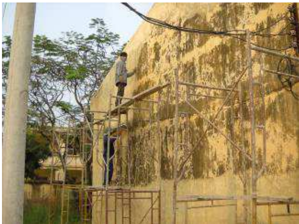
Photo 2: Vorher: Am 14.01.2011 hatten wir „Stunden der offenen Türen“. Beide unsere Hallen 1 und 2, sind auf der Westseite waren in einem sehr schlechten Zustand. Wir haben in Erwägung gezogen, dass wir mit den Lehrlingen oder wir gar selber, diese Hallen auf der West Seite neu malen und zwar dieselbe Farbe, wie die anderen Seiten. Die Direktion liess dann eine Offerte machen, sie sagte uns den Preis und wir gaben das ok. Danach sahen wir diesen Malern zu, wie sie über den Schmutz malten. Es wurde uns versprochen, es in Ordnung zu bringen.
