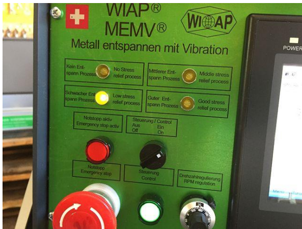
Steuer Gerät mit Status Anzeige vom MEMV_E
