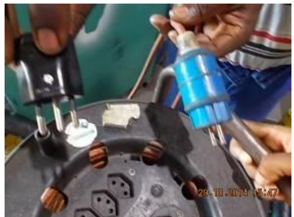
Bild 48a) Viele Kabelrollen bei der Algoa haben die Schweizer Stecker. Diese sind ausgelegt für 10 Amp. Jetzt werden bei vielen die Stecker abgeschnitten und neue montiert.
