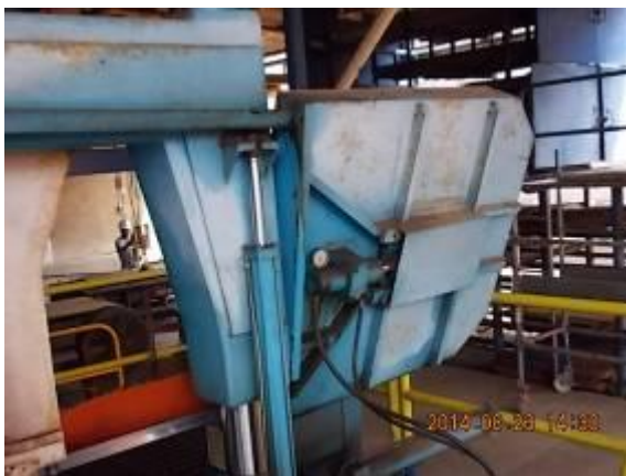
Bild 46) Hier eine Knuth Bandsäge aus der Türkei. Sie steht circa 5 Jahre hier. Die Farbe ist wahrscheinlich eine neue, wasserlösliche Farbe. Sie fällt ab. Diese Maschine müssen wir bei Gelegenheit neu und gut malen.
