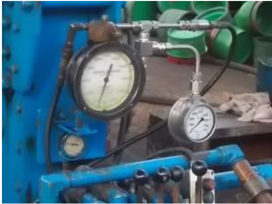
Bild 72) Eine erweiterte Manometer Lösung erleichtert das Arbeiten an der Maschine.
