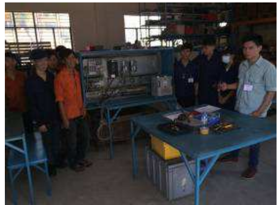
P48 Elektro Schrankbau
