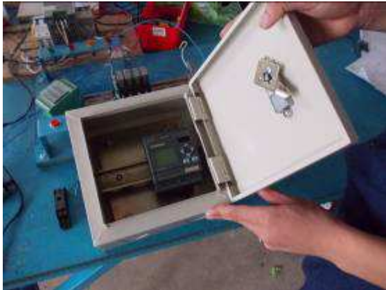
Photo 10: Im Raum 6a in der Elektroabteilung, beginnen wir jetzt so genannten „Tropen Cabinet Control“ Boxen. Wir wollen eine Überwachung gegen Kondenswasser machen in Elektroschränken. Die Ware haben wir gekauft. Wir werden jedoch alles in die Schweiz senden und dort fertig machen. Hier in Vietnam erkennen wir immer noch viel zu wenig Qualitätsdenken.
