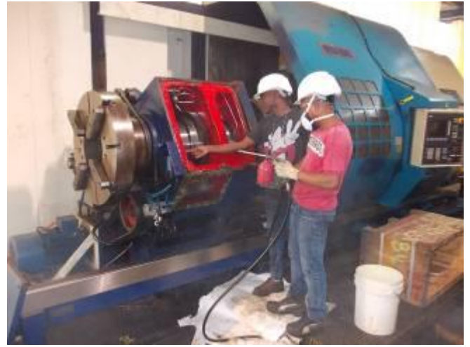
P8: A transmissão foi lavado para fora
